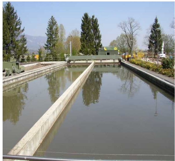
Foto: Zweckverband Abwasserregion Grenchen
