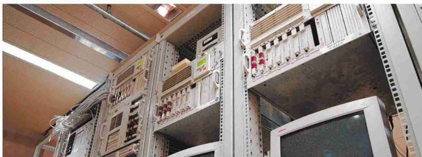
Informatik: Serverraum in einem Unternehmen der Region AZ
