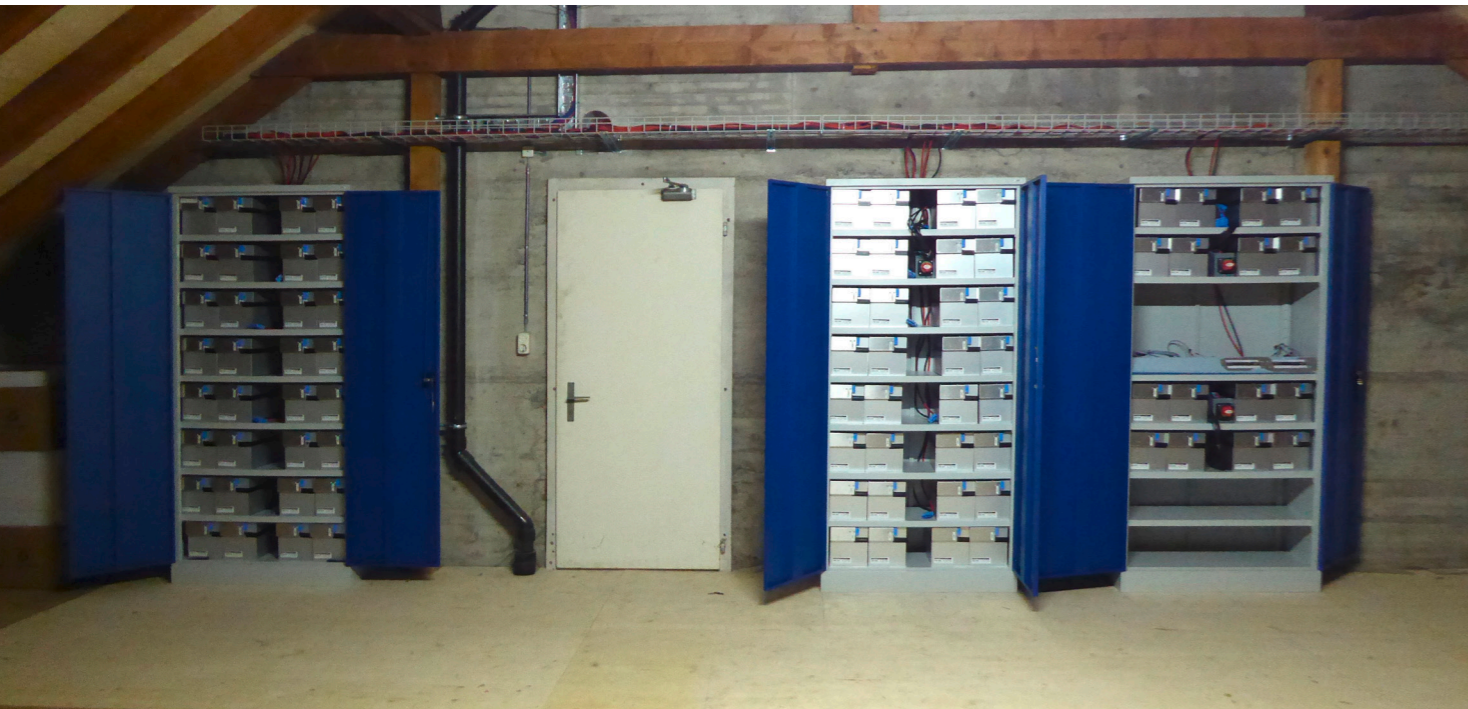
In der Alterssiedlung in Riehen wurden 2560 gebrauchte Batteriezellen zu einem Speicher mit einer Kapazität von 60 kWh verbaut.
