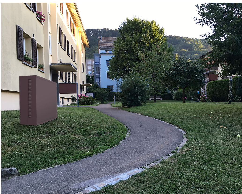
Abbildung 77: Grosse Luft/Wasser-Wärmepumpe farblich abgestimmt auf Briefkastenanlage.
