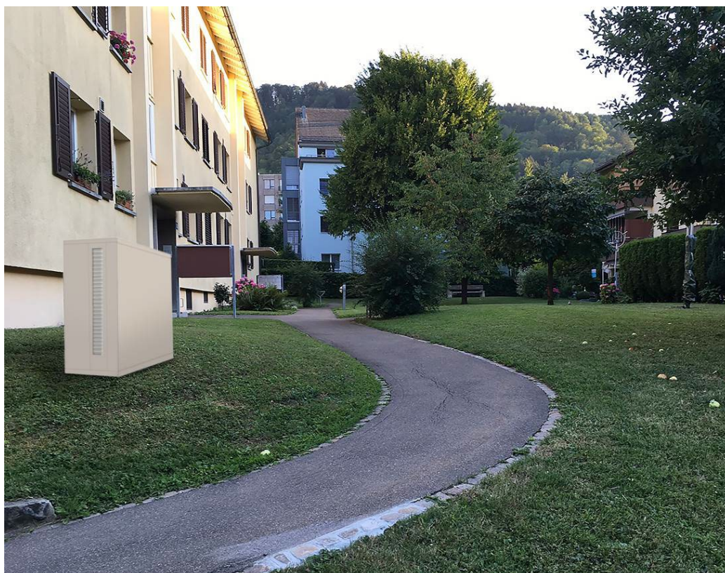
Abbildung 76: Grosse Luft/Wasser-Wärmepumpe farblich angeglichen an Fassade.
