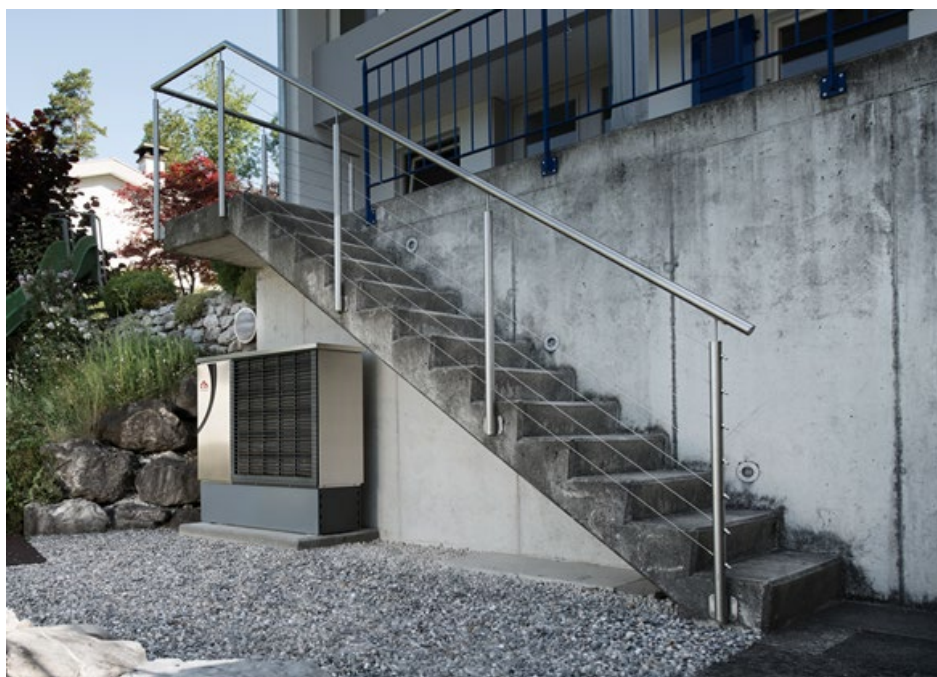
Abbildung 10: Aussen aufgestellte Luft/Wasser-Kompaktwärmepumpe. Quelle: CTA
