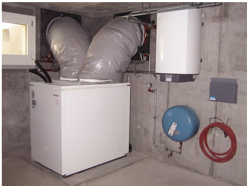
Abbildung 9: Innen aufgestellte Luft/Wasser-Kompaktwärmepumpe. Quelle: Schwab HSK
