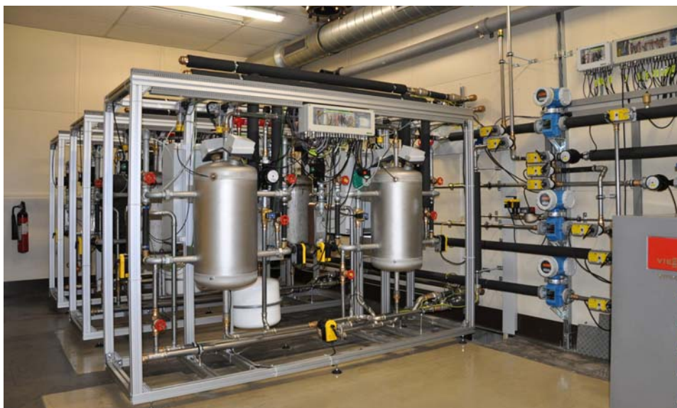
Abbildung 3: Emulationsmodule für Sonnenkollektor (Vordergrund), Erdwärmesonde und Gebäude. Pro Modul sind jeweils zwei Speicher vorhanden, welche mit Wärmeübertragern, Zusatzheizungen und Mischventilen dynamisch geregelt werden (Foto: C. Messmer)
