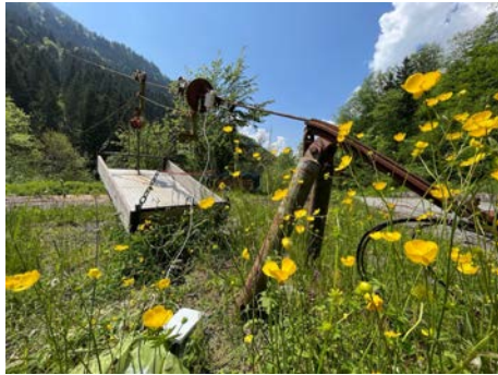
Materialseilbahn mit installierter Sensorik (Foto: Michel Roth)
