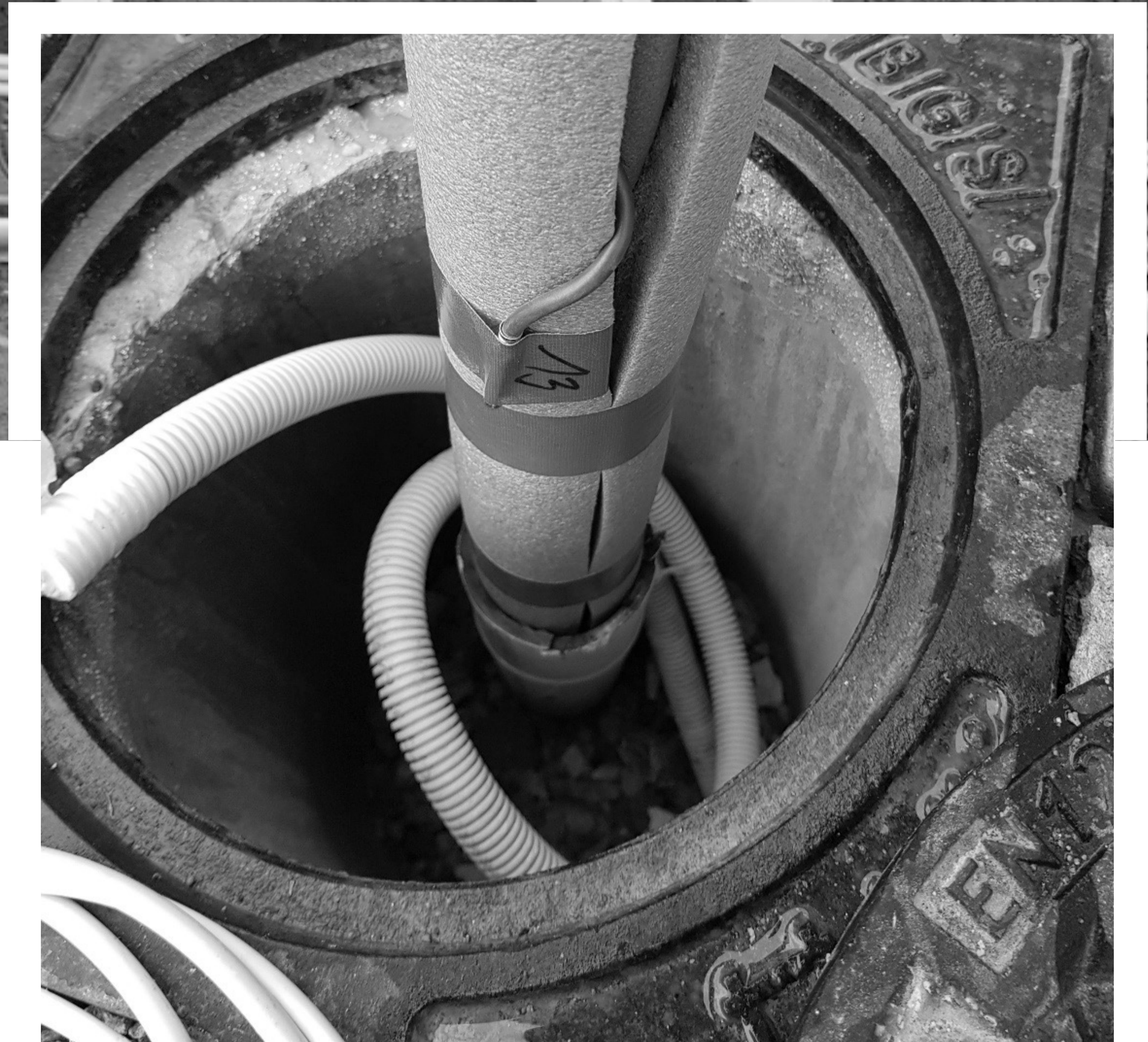
Abb. 2: PT1000 Temperatur-Sensoren, die als Messsystem im Abstand von 45 cm in einem Rohr verteilt werden.
