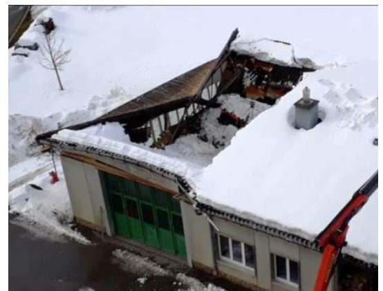
Abb. 2: Dacheinsturz auf Grund zu hoher Schneebelastung ( www.20min.ch )
