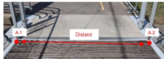
Abbildung 1: Empirische Genauigkeit der geeignetsten Messgeräte für die Überprüfung von vorgefertigten Strukturen (Fahrbahnplatte) in Cevio (TI)
