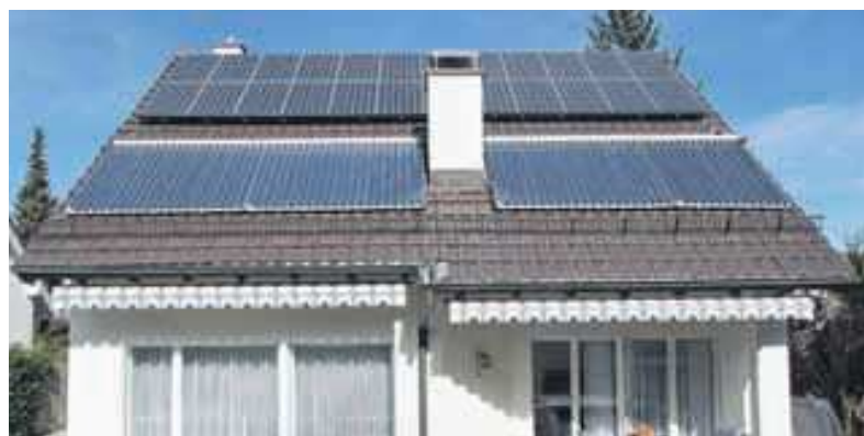
Das Haus am Girenwaldweg 7 in Bettingen mit Fotovoltaikanlage. Foto: zVg
